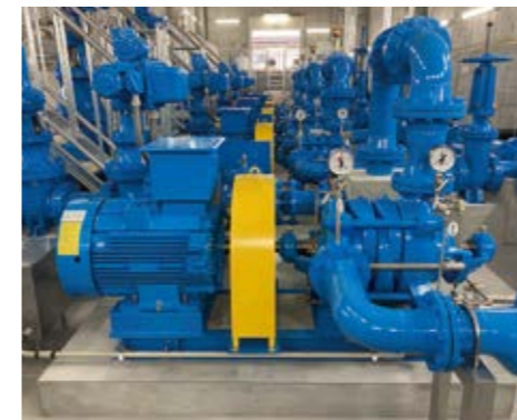
加圧ポンプ 受水槽の水道水を各配水池へ加圧送水します。
