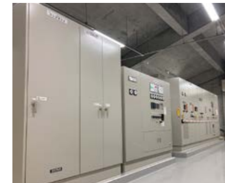
電気設備 ポンプ所の運転状況を常時監視し、中央操作室からの各機器の遠方操作と状態表示が可能です。
