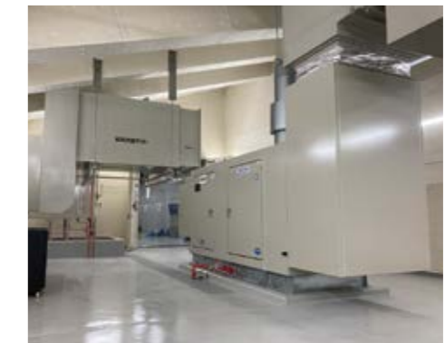
非常用自家発電装置 停電時ポンプへ電源供給するための発電設備
